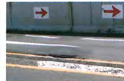
舗装の損傷状況イメージ
